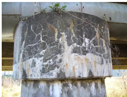
写真 1.3 橋脚ひび割れ
