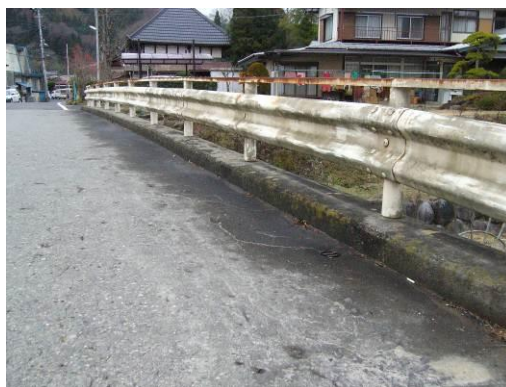
写真 1.2 ガードレール塗装劣化
