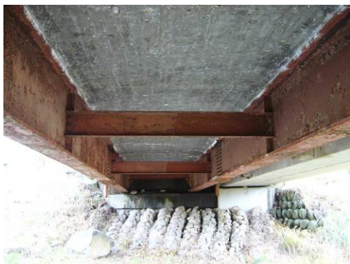
写真 1.1 主桁塗装劣化
