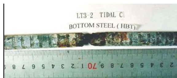
図－3.1.3.15 干満部に 23 年間暴露した RC はり供試体の内部鉄筋の腐食状況の一例（治癒が生じていないひび割れ箇所が発生した著しい断面欠損、かぶり＝20mm）[30]
