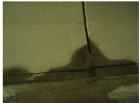
図-6.1.1.2 覆工コンクリートとインバートコンクリートの境目などからの漏水
