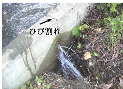
図-6.2.1.1 水路構造物からの漏水
